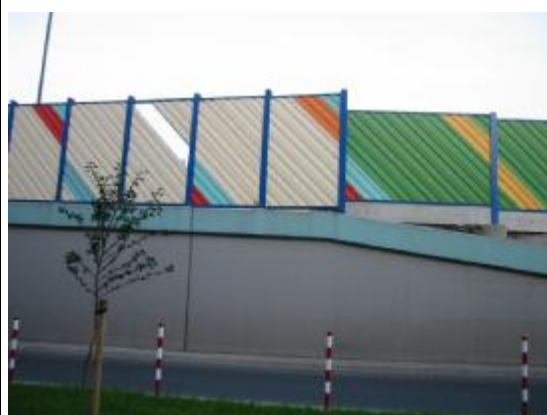
Lekkie ekrany pochłaniające na wiadukcie
